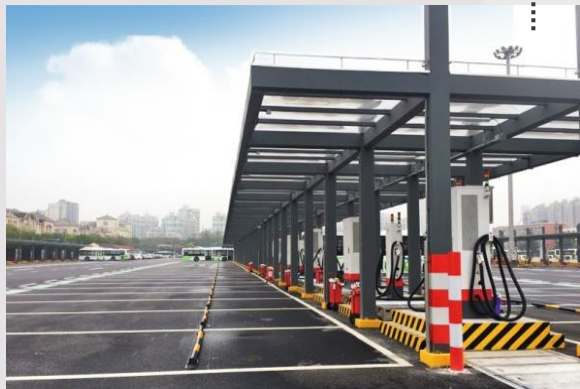
9.6MW зарядная станция в Шанхае.
