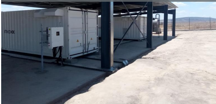
Проект на 500kWp PV+500kW/1524kWh ESS+500kW гибридной системы на Мадагаскаре
